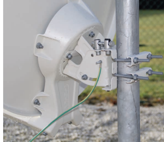
Rückseite der massiven Satantenne
